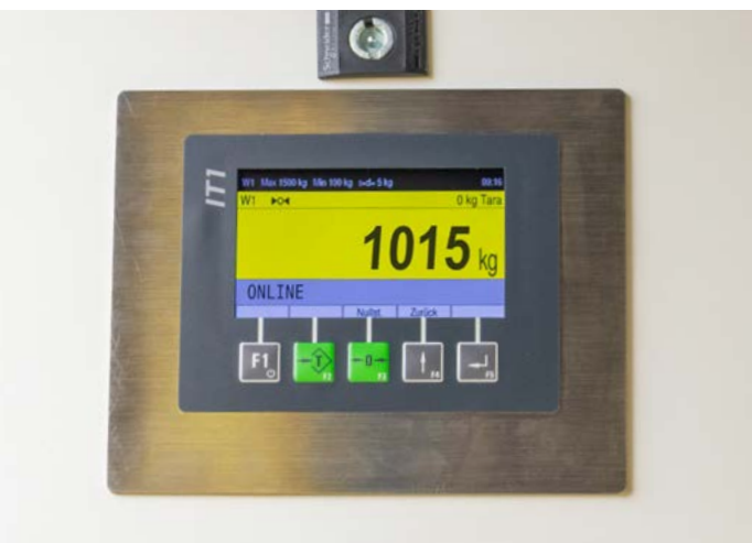
Wyświetlacz w ścianie szafy sterowniczej
